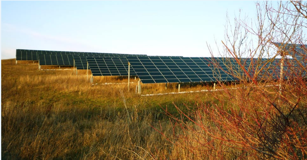
Solaranlage auf der Deponie in Rehestädt
